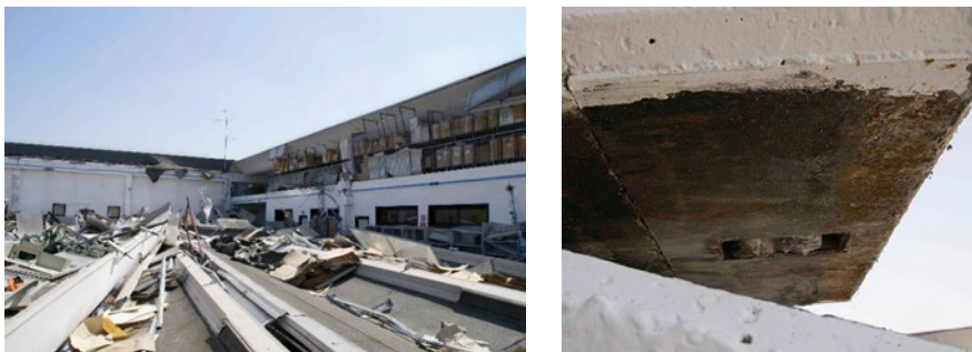
Figura 9. Il collasso della parte centrale della copertura, che mostra la disposizione a lisca di pesce dei coppioni crollati, ed un dettaglio di rottura della barra di connessione.
