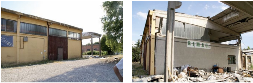
Figura 3. Perdita d'appoggio delle travi di coperto per la presenza dei tamponamenti solo su una porzione dell'edificio.
