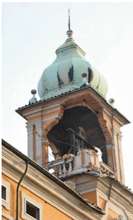
Figura 1. Il torrino sulla sede municipale di Finale Emilia dopo il sisma del 20 maggio. Le scosse del 29 maggio hanno fatto crollare completamente questo manufatto.
