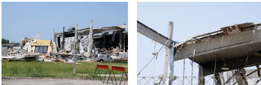
Figura 6. Perdita d'appoggio degli elementi di coperto per la presenza di un soppalco irrigidente destinato ad uffici.
