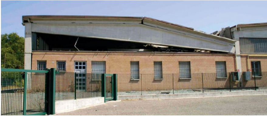
Figura 2. Perdita d'appoggio delle travi di coperto per la presenza di pilastri che assumono rigidzze diverse per la presenza della muratura di facciata.
